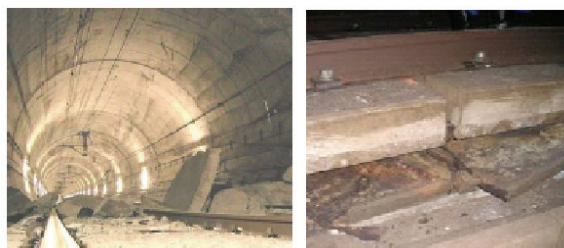
図-5.4 トンネルの被害状況
