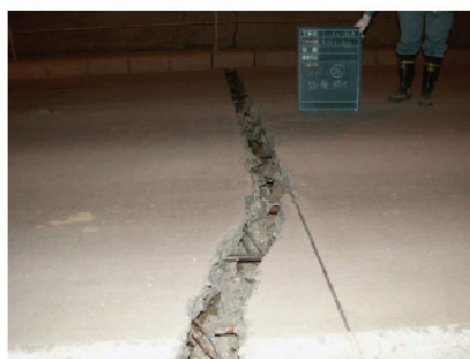
図-5.5 トンネルの舗装版のひび割れ
