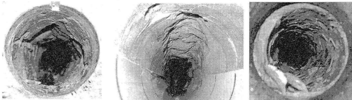
写真-1 無支保状態の水平試錘孔における孔壁崩壊状況
