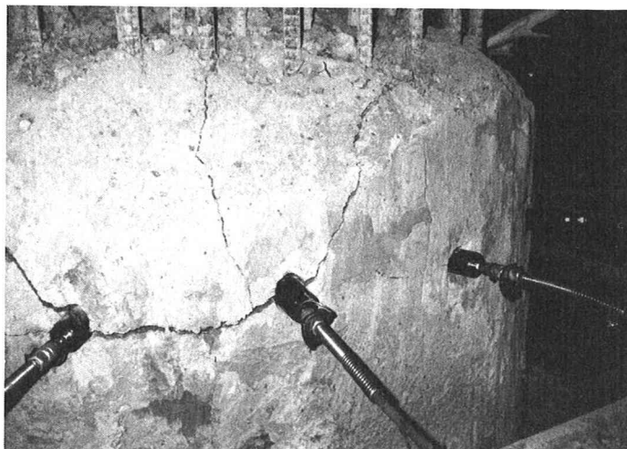
写真-3 破碎状況
