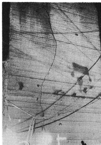
写真2. ピラーの縦割れ
