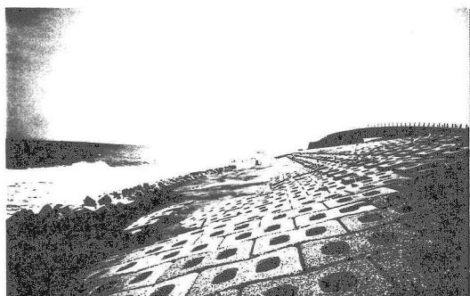
写真-16 直接波に晒されている緩傾斜護岸のり先
