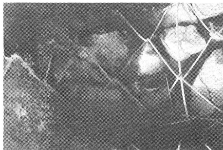
写真-3 目詰まりが生じた蛇籠
