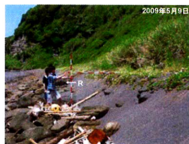
図-11 海浜aの測線①付近での浜崖形成 (2009年5月9日)
