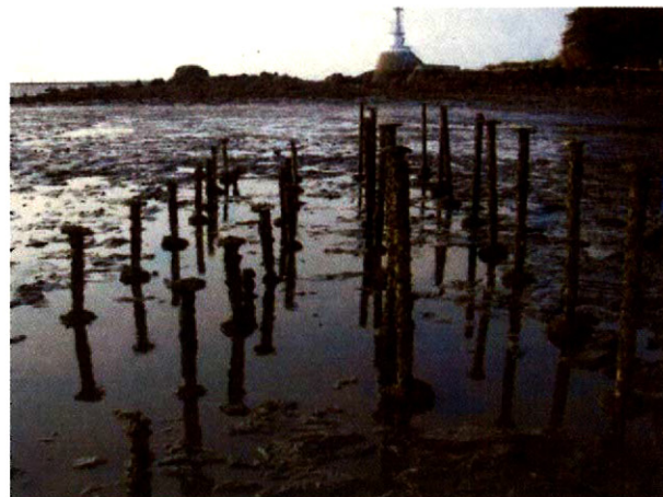
写真-2 設置24週後での洗掘状況
