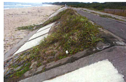
写真-1 法枠式傾斜護岸
