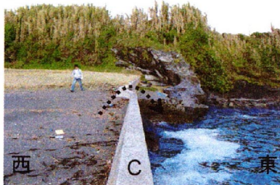
図-10 突堤Cの左右岸における堆積状況の差異
