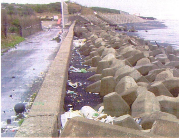
図-6 測線No. 12-15付近の護岸前面の状況 (2006年10月7日)
