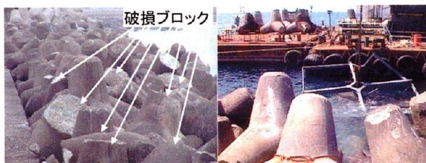
写真-8 25tブロック破損状況及び回収作業
