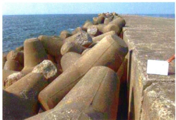
写真-14 消波ブロックの断面減少状況
