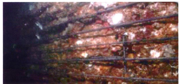
写真-11 本体工鉄筋の広範囲露出状況（水中部）
