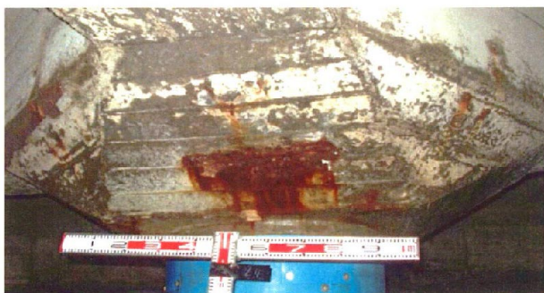
写真-2 杭頭部に部分的に発生している錆汁
