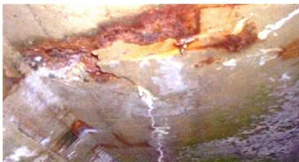
写真-3 スラブの複合的な変状
