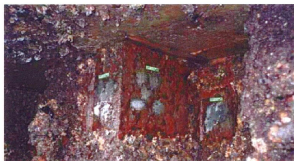
写真-5 鋼矢板の全体的な錆の発生
