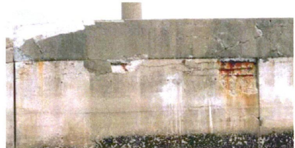
写真-10 本体工鉄筋の広範囲露出状況（気中部） （上部工の欠損、ひび割れあり）
