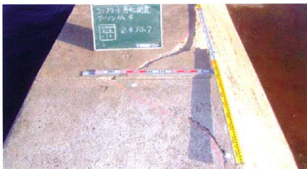
写真-8 パラベットの小規模な欠損
