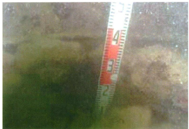
写真-13 被覆工法尻の30cmの洗掘状況（「b」判定）
