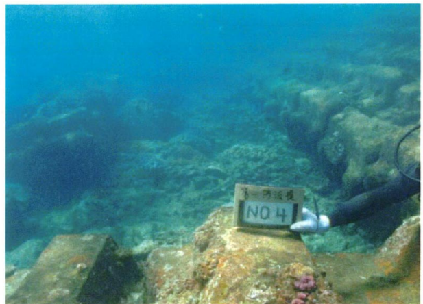
写真-12 被覆ブロック消失箇所（「a」判定）
