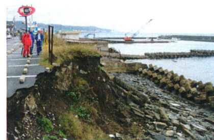
図-13 本港の南側の侵食が著しい場所の状況 (X=3.5km: 図-1 の④)
