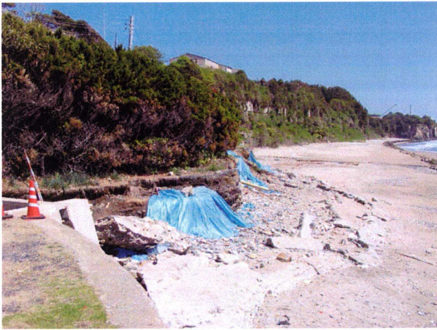
図-13 壊れた護岸と背後地の侵食
