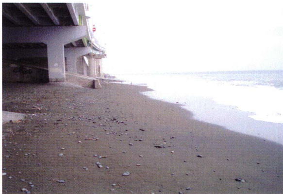
図-8 金波橋直下の海浜状況（2007年9月4日撮影）
