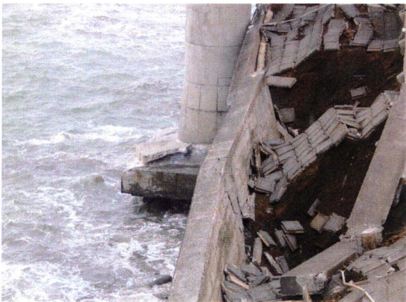
図-3 銀波橋橋脚部の被災状況 (9月9日撮影)
