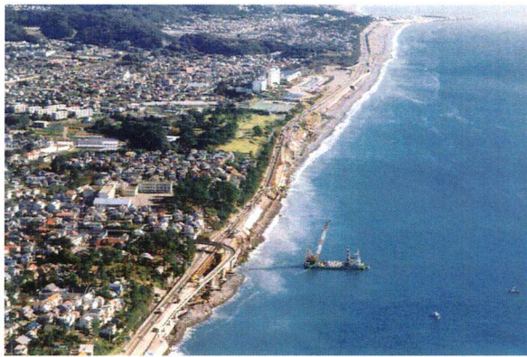
図-7 被災区間の斜め空中写真（11月13日撮影）
