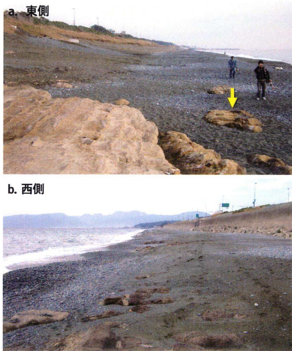
図-20 葛川河口東側に露出する基盤岩の状況 (2007年11月20日撮影)
