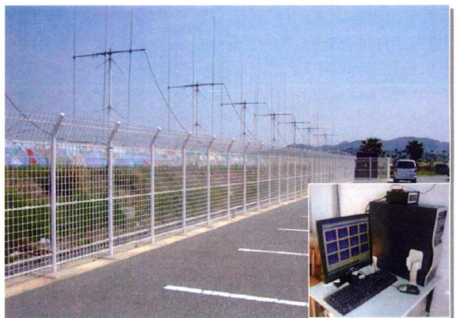
図-1 海洋短波レーダー観測施設(宇土局)
