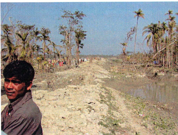
写真-12 越流による堤防の侵食 (地点9) (左: 堤内, 右: 堤外)
