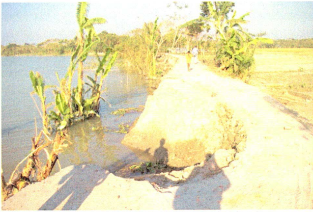
写真-6 河川堤防の被害状況（地点1）
