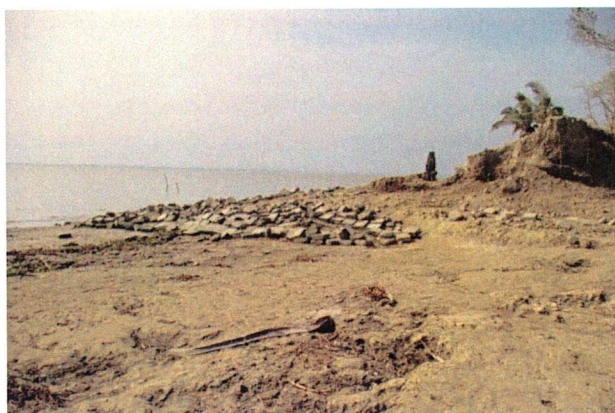
写真-9 破堤地点北側の状況（地点7）
