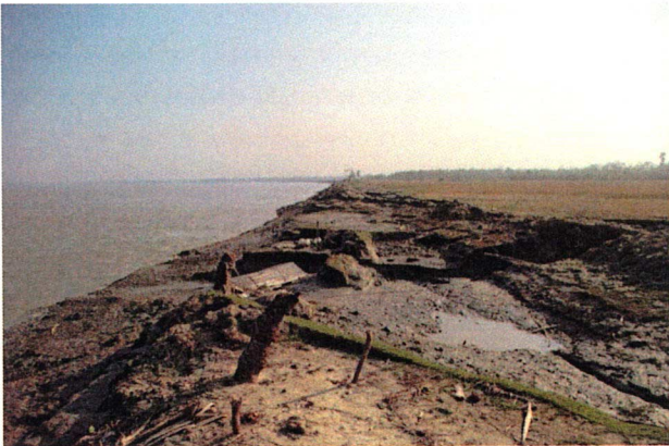
写真-7 河岸侵食による堤防の消失（地点6）
