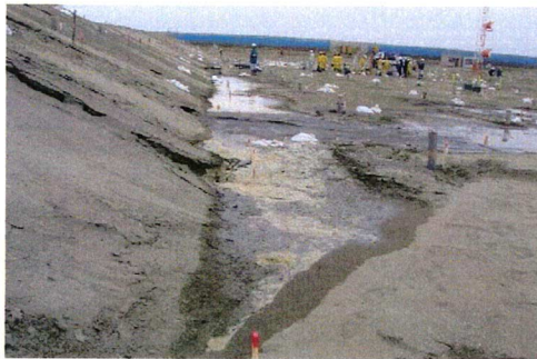
写真-4 液状化発生状況（盛土のり尻部）
