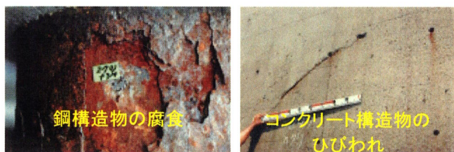
図-2 構造物の老朽化の現状
