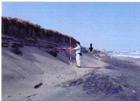
図-6 排水口の北側における浜崖形成状況
