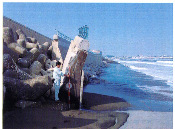
図-11 立護岸の被災箇所の北側の状況(図-1のe)
