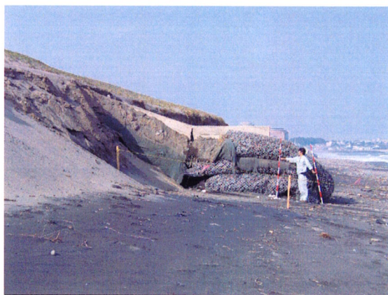
図-5 排水口の被災状況(図-1のb)
