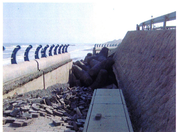
図-12 遊歩道の被災状況(詳細)
