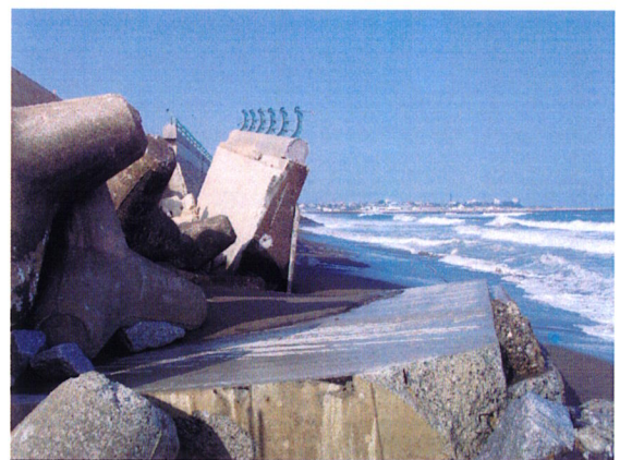
図-10 倒壊・前傾した直立護岸
