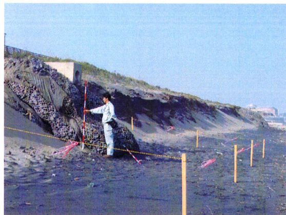
図-7 第2の排水口周辺の侵食状況(図-1のc: 図-6の矢印)
