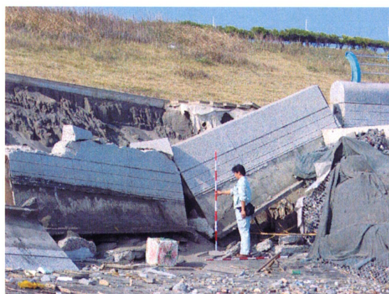
図-9 大洗水族館の駐車場を取り囲む護岸の被災状況と露出した護岸の基礎(図-1のd)
