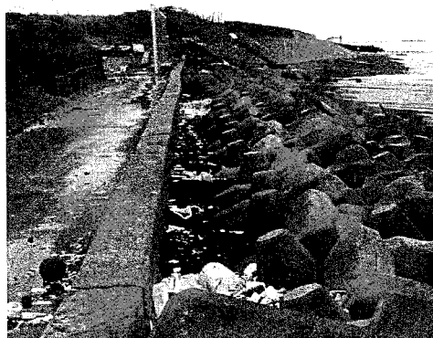
図-11 測線No.12-15付近の護岸前面の状況 (2006年10月7日)
