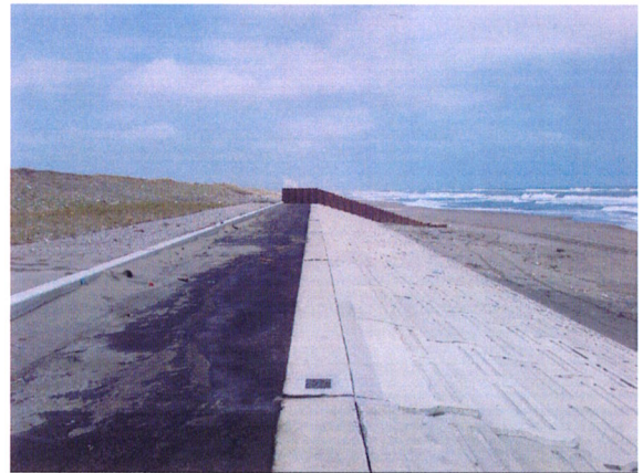
図-15 端部で矢板による暫定処理が行われた 保安林の護岸
