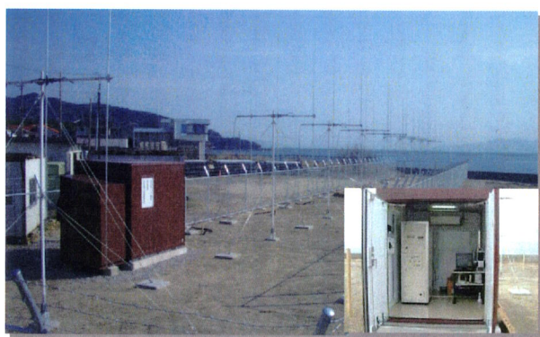
図-2 海洋短波レーダー観測施設
