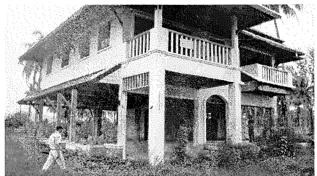
図-3(1) Khao Lak海岸A地点での被災後地上写真 (2005 年 1 月 10 日：衛星写真では屋根が邪魔して判読できなかったが、1 階部分の壁がほぼ無くなってしまっている)
