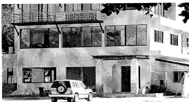
図-5 Patong beach B 地点での被災後地上写真 (2005 年 1 月 12 日：1 階部分の窓が浸水により 完全に破損しているが、それ以上の破壊はない)
