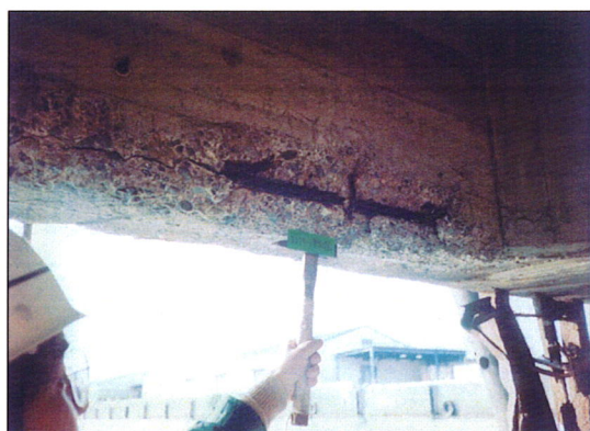
写真-2 栈橋上部工の劣化事例
