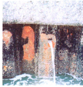
写真-1 矢板の腐食劣化事例とエプロン部の陥没
