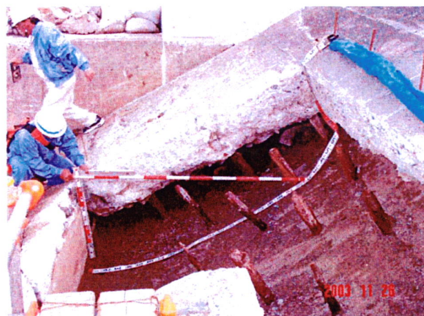
写真-1 松名瀬工区における堤防空洞化の様子 6)
