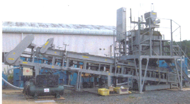
写真-3 大型処理装置
