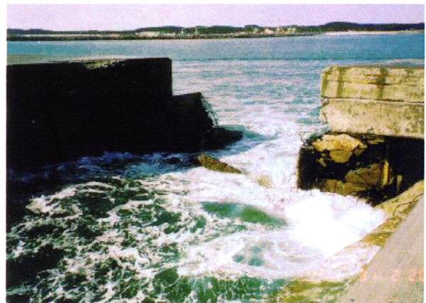
写真-1 ケーソン壁の被災事例
