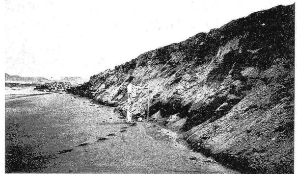
写真-1 養浜盛土の基部に形成された浜崖
