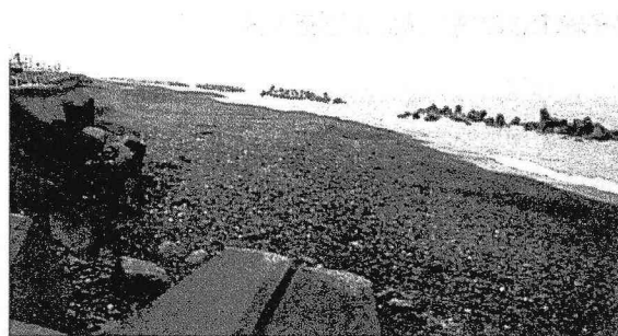
写真-1 離岸堤の沈下状況
