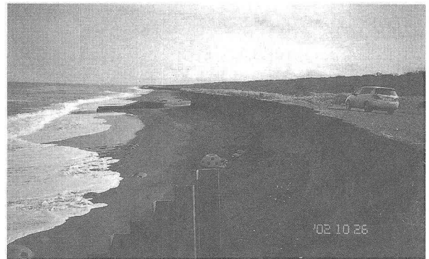
写真-16 大部分が削り取られ、車両の通行が困難となった管理用通路
