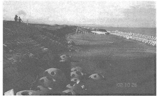
写真-14 陥没・沈下して機能を果たさなくなった護岸と沖合の消波堤
