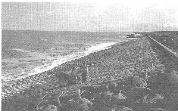
写真-13 1/4 勾配の緩傾斜護岸。のり先が海中にあるため常時波がうちあがっていた
