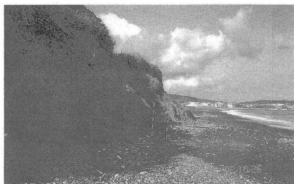
写真-2 紋別港の南側の藻別川河口東側隣接部に形成された高さ約7mの浜崖
