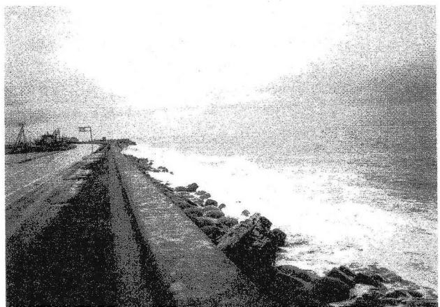
写真-3 野付崎海岸の侵食状況 (平成14年10月撮影)
