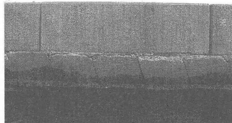
写真-2 ブロック最上段天端角部の欠損
