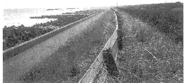
写真-7 北九十九里・三川地先付近の海岸状況
