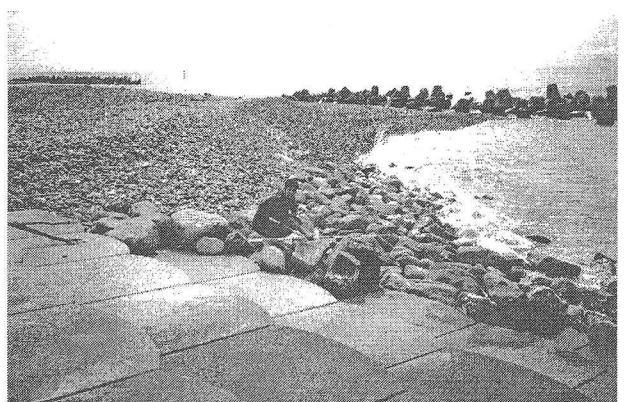
写真-8 2号離岸堤背後の舌状砂州端部に集積した捨石
