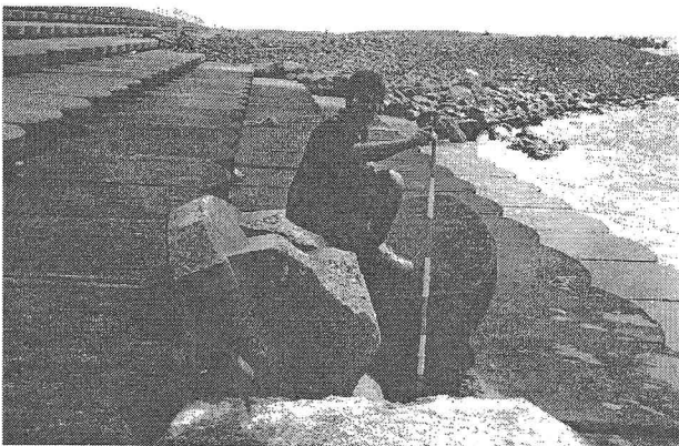
写真-7 2号離岸堤隣接部における緩傾斜護岸の被災状況
