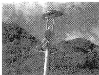
写真-4 津波警報装置（田原市）
