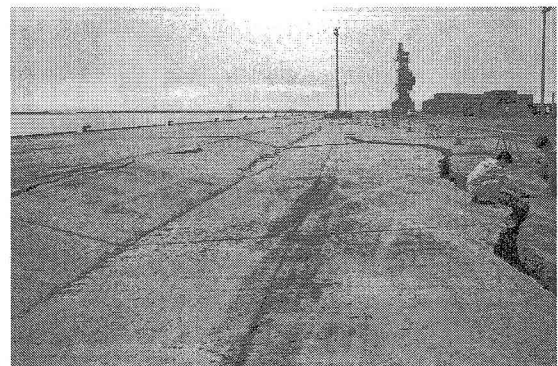
図-3 -10m岸壁被災状況
