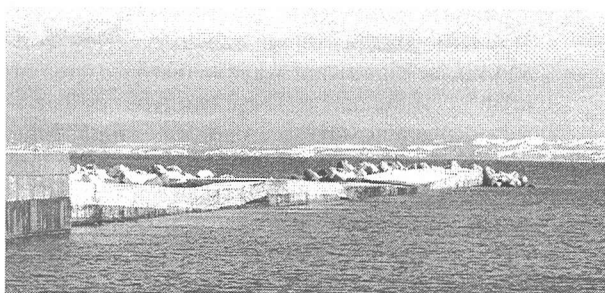
写真-1 沈下状況
