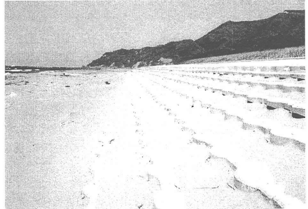
写真-7 野積海岸における飛砂による護岸埋没状況
