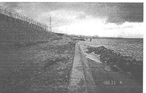
写真-12 護岸背後での土砂の吸い出された跡
