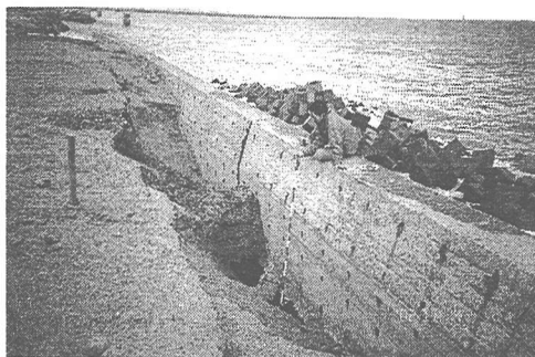
写真-13 約2m規模の大きな陥没穴
