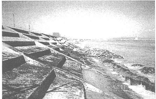
写真-4 災害区域の状況
