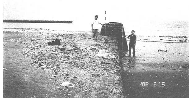
写真-2 突堤を挟む左右の地盤高の差
