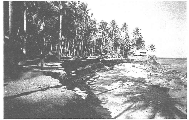
写真-15 破壊された護岸の岸側の侵食状況 (図-2のD付近で2002年8月9日撮影)
