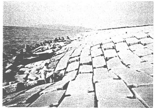
写真-5 陥没した緩傾斜護岸
