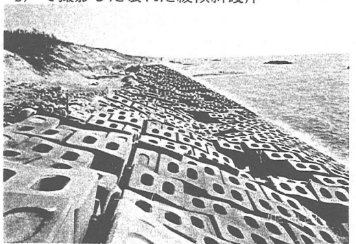
写真-3 崩壊した緩傾斜護岸を南向きに撮影
