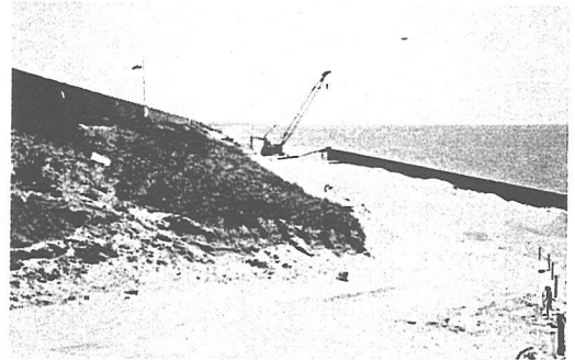
写真-4 海浜地における矢板打設状況 (図-2 (b) の④で南向きに撮影)
