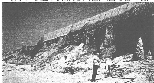
写真-9 崩落した防潮柵を北向きに撮影
