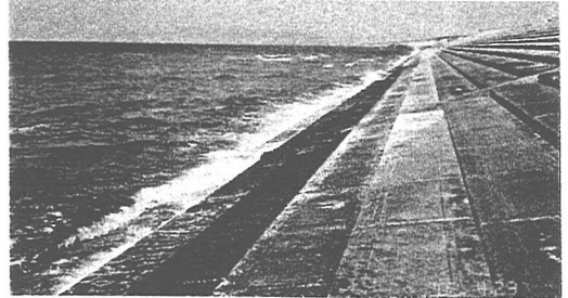
写真-6 中村浜に建設された緩傾斜護岸 (図-2 (b) の⑤で北向きに撮影)
