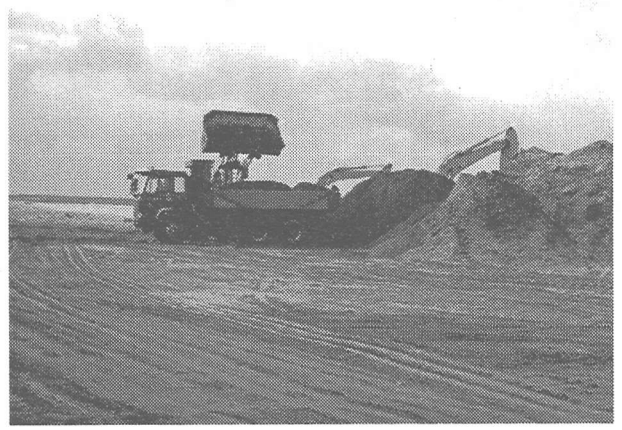
写真-11 掘削土砂の積み込み状況。ダンプトラックはひっきりなしに土砂を運搬していた。
