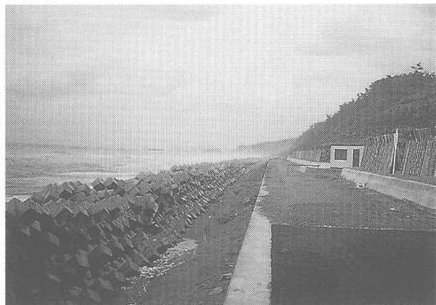
写真-7 波松海岸の侵食箇所
