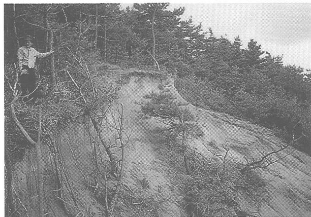
写真-5 海食崖上部の崩壊状況
