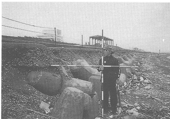
写真-8 侵食域における浜崖形成状況
