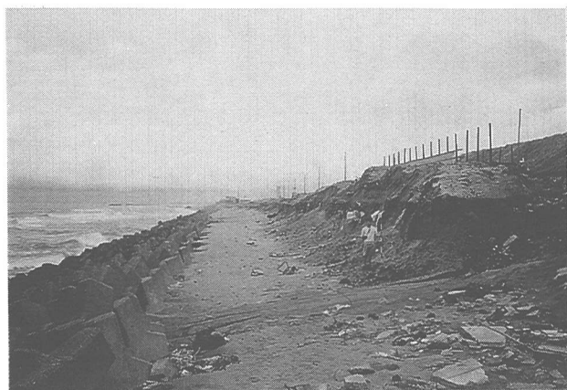
写真-2 五十嵐浜の西端付近に形成されている消波堤背後の浜崖状況（東側を望む）
