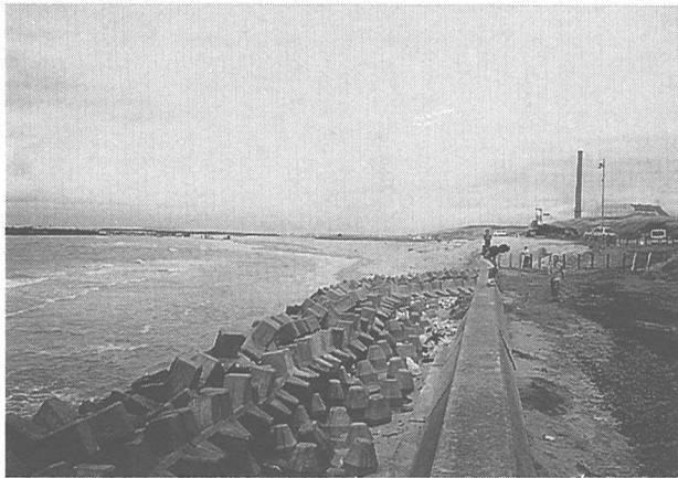
写真 - 5 新川漁港の西側隣接部から始まる直立護岸の基点付近の海岸状況
