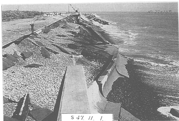
写真-8 倒壊後の海岸堤防を東向きに撮影（11月1日）
