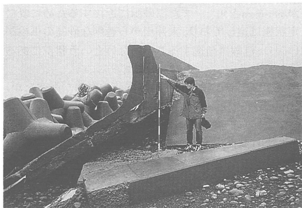
写真-13 壊れた海岸堤防の側面
