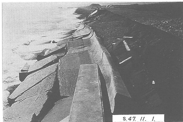
写真-9 倒壊後の海岸堤防を西向きに撮影（11月1日）
