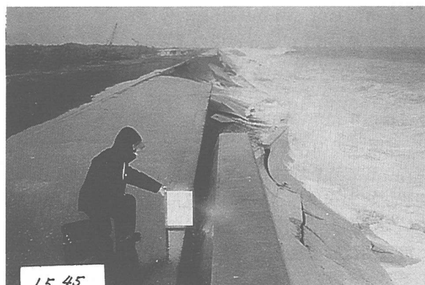
写真-7 海岸堤防の倒壊状況 (10月31日 15:45)
