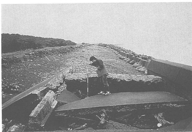
写真-12 吸い出されて倒壊した海岸堤防
